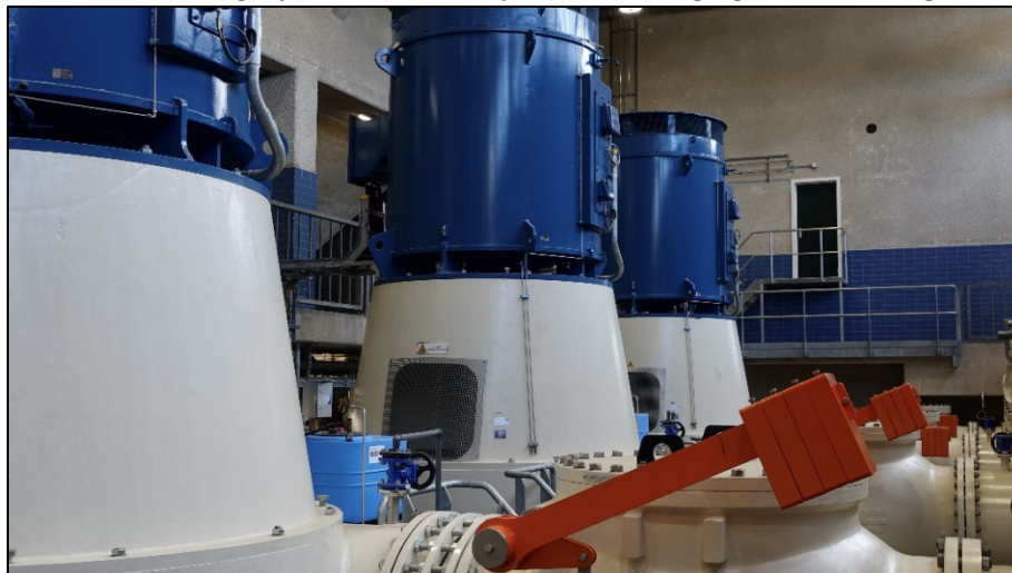
Twée RWA-pompen bij persstation Bergen op Zoom zijn voldoende om al het afvalwater te verpompen. De 3 e pomp staat stand-by.
